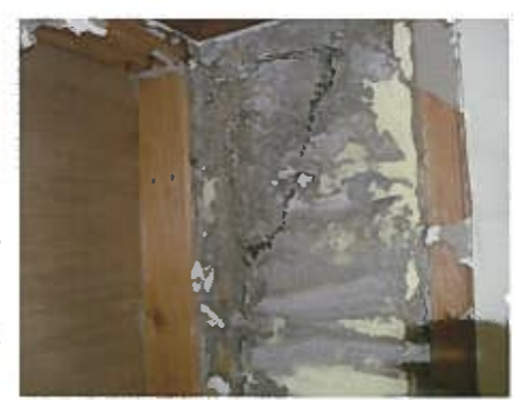
写真3 壁内部の分巢
