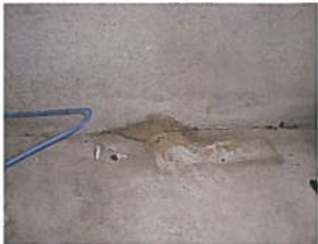
写真4 最初の侵入に使用した蟻道
