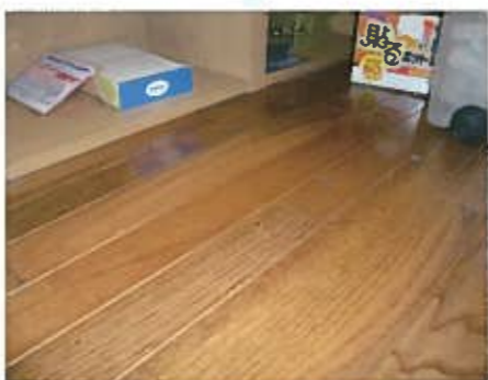
写真2 フローリングの盛り上がり
