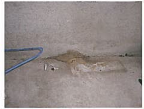
写真4 最初の侵入に使用した蟻道
