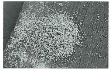
アメリカカンザイシロアリのフン。天井裏にはこうした粒状のフンが大量にたい積していた (写真：本誌)
