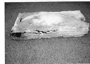
写② 断熱材の被害
