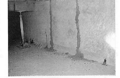
⑥べた基礎からの侵入
