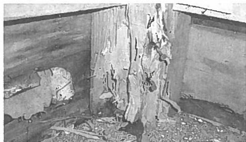
アメリカカンザイシロアリの被害に遭った家の天井裏。柱が食い荒らされている。下に散乱している顆粒状のふんが、発見の決め手になる＝東京都内（関東白蟻防除提供）
